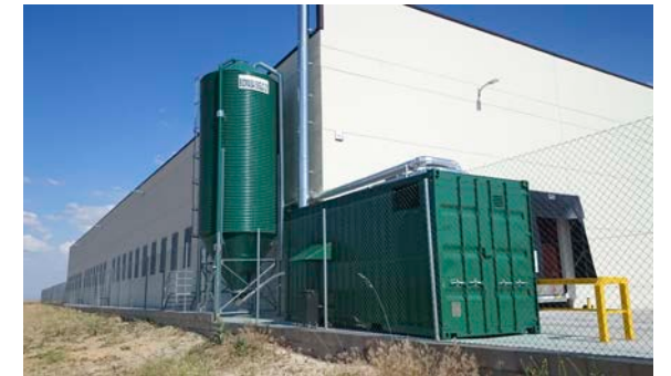
Instalación en secadero de jamones.
