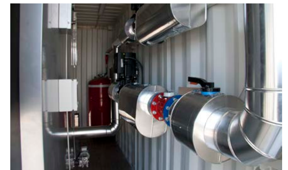
Detalle instalación hidráulica.
