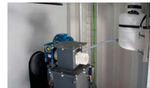
Detalles instalación hidráulica e interior
