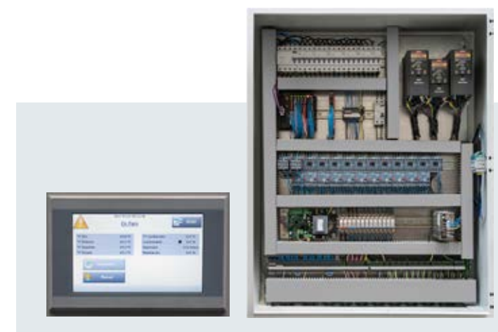
Cuadro y display de control con PLC
